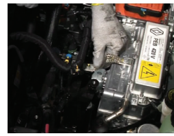
4. Poner a tierra y en cortocircuito
